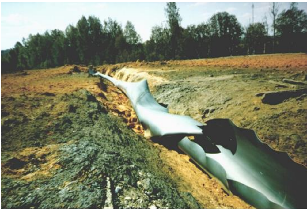
Рисунок 1.7 – Вязкое протяжённое разрушение с большой утяжкой магистрального газопровода Торжок-Минск-Иванцевичи, 1998г.
